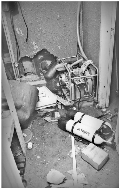
Kompressorrykmet efter sprængningen. Der er slået hul i væggen, hvor karret stod. Den sprængte flaske ligger i hullet i væggen, og mellemstykket fra det sprængte flaskesæt med 1½ ventil ses koblet til fyl-deslangen
