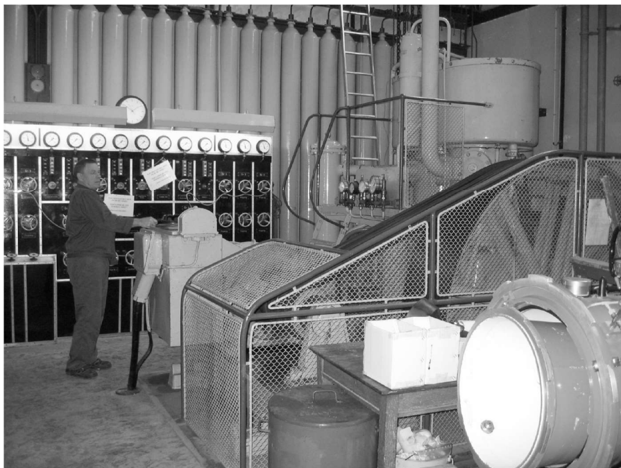
En af de store kompressorer tager omdrejningerne efterhånden som motoreffekten øges Bemærk luftbanken på bagvæggen.
